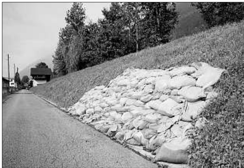
Die Dämme haben gehalten: Nur an ganz wenigen Stellen, wie hier am Muota-Damm in Brunnen, mussten Notmassnahmen ergriffen und Verstärkungen eingebaut werden.
