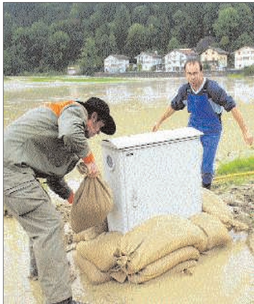
Letzte Hoffnung: Sandsäcke sollen diesen Elektro-Kasten in Goldau schützen.
